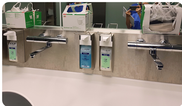
Abb. 1: Kontaminationsgefahr durch Handwaschbecken, Foto BZH GmbH
